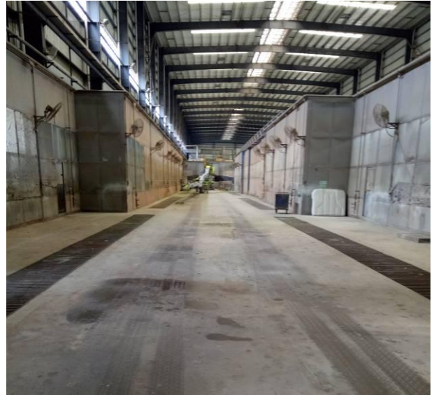
底灰打磨废气地下收集管道
