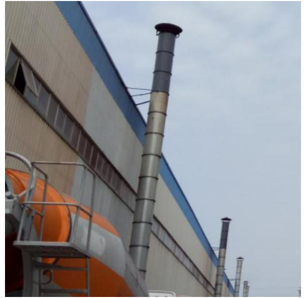
下料车间排气筒
