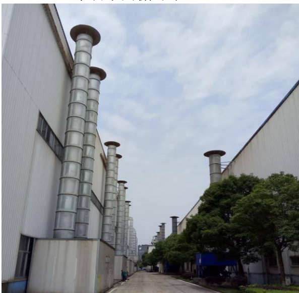
涂装车间排气筒
