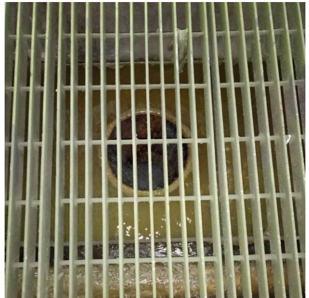
水旋式喷漆室废气收集口
